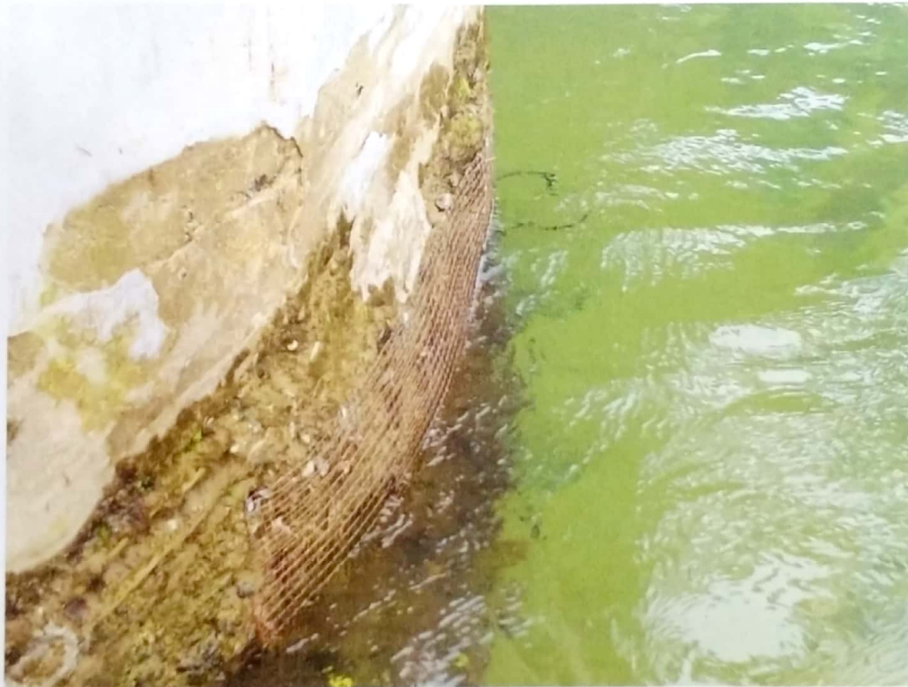
Gambar 7. Kawat pelindung yang dipasang pada sumur intake agar tidak ada sampah yang masuk. Plesteran beton sudah terkelupas akibat konstruksi sumur intake yang berada di dalam sungai (Sumber: Dokumentasi Lapangan)
