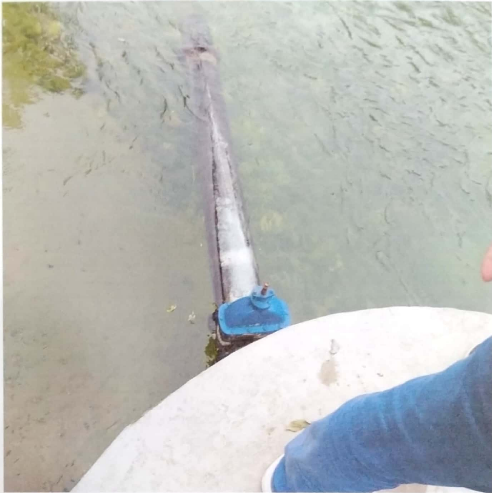
Gambar 5. Pipa yang mengarah ke hilir di sumur intake (Sumber: Dokumentasi Lapangan)
