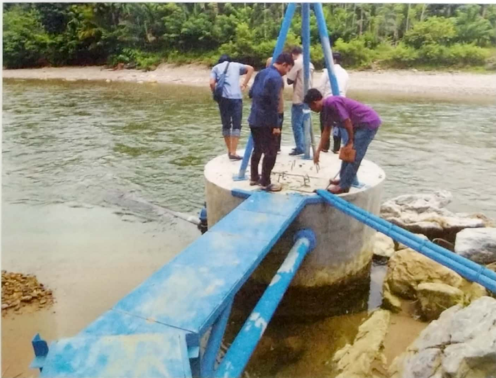
Gambar 6. Intake Blangpidie yang berbentuk sumuran (Sumber: Dokumentasi Lapangan)
